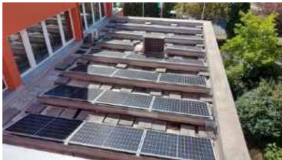
Napelemek a tetőfelületen
