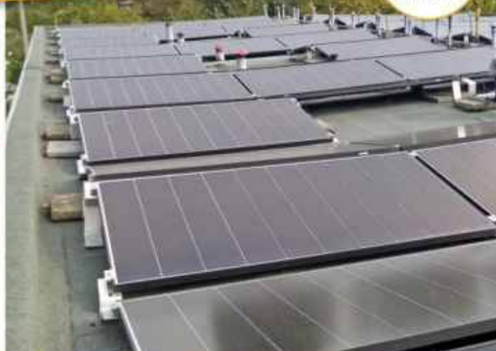
II. Termálkút - Telepítés éve: 2022, Teljesítmény: 40 kw
